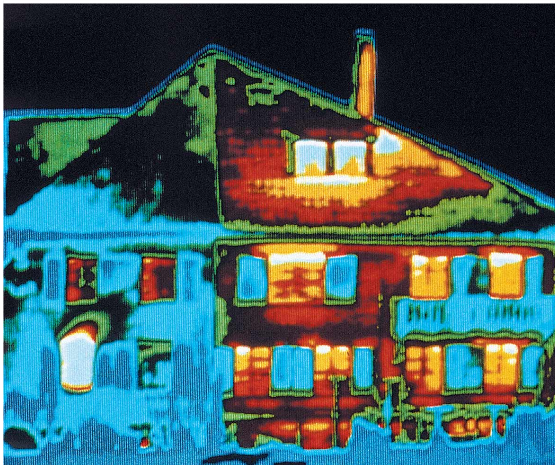
Thermografisches Bild eines Hauses: Warme Stellen (rot) signalisieren schlechte Isolation – kalte Stellen (blau) gute Dämmung
